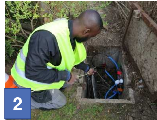
2 Récupération du Point de Branchement Optique (PBO) de votre logement
