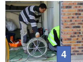
4 Arrivée de la fibre dans votre sous-sol ou garage
