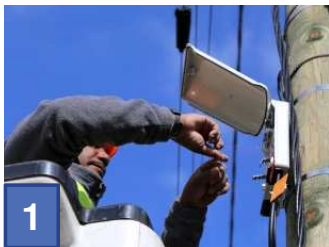
1 La fibre est en attente dans le PBO au niveau d'un poteau de votre rue
